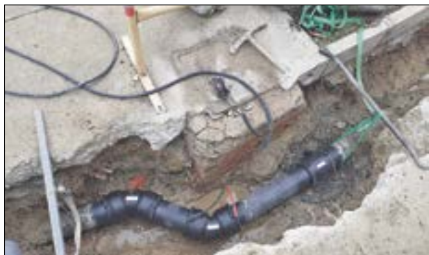
Una de les fuites que s'ha reparat. // F: DIBA
